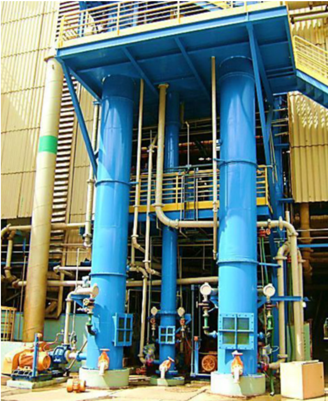
Vista do circuito de flotação para concentração de barita.
