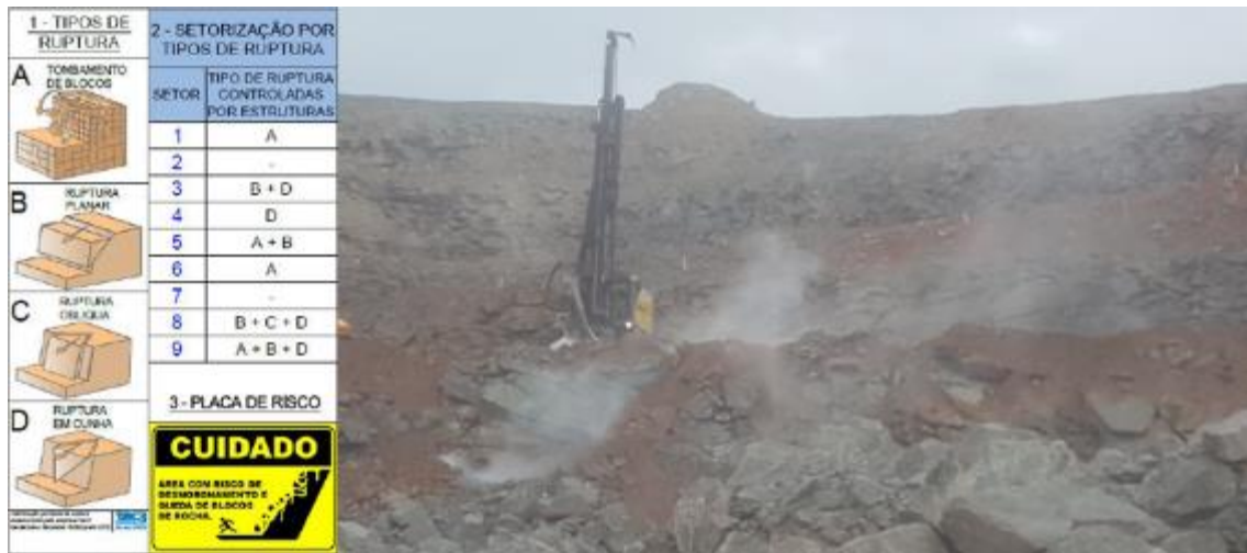
FIGURA 2 – Tipos de ruptura e setorização por tipos de ruptura e foto mostrando o ar comprimido dissipado pelas fraturas durante a execução da perfuração.
