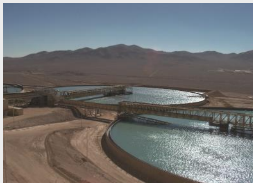
Espessadores para rejeitos
